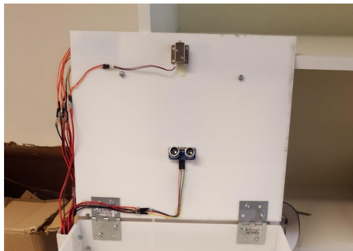
Slika 6.7. Ultrazvučni senzor na konstrukciji
