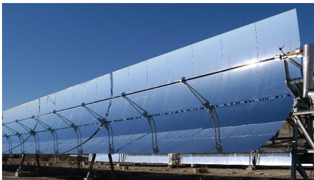
Slika 5. Solarna elektrana s paraboličkim kolektorima [15]
