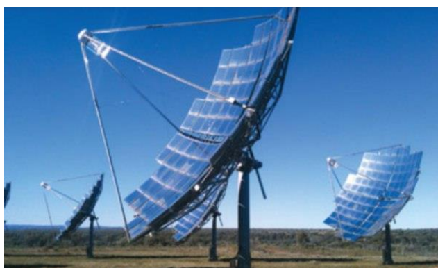
Slika 3. Solarna elektrana s paraboličkim solarnim tanjurima [16]
